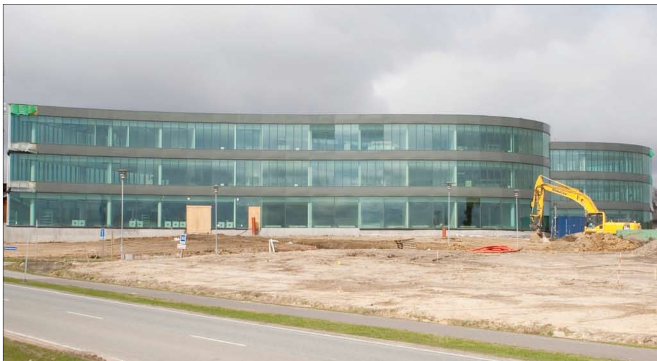
ELRO's nye domicil er tænkt energirigtigt fra begyndelsen. Et jordvarmeanlæg, der anvender overskudsvarmen fra serverparken i SkyLines IT-driftscenter, dækker hele behovet for opvarmning og køling af domicilet året rundt.
